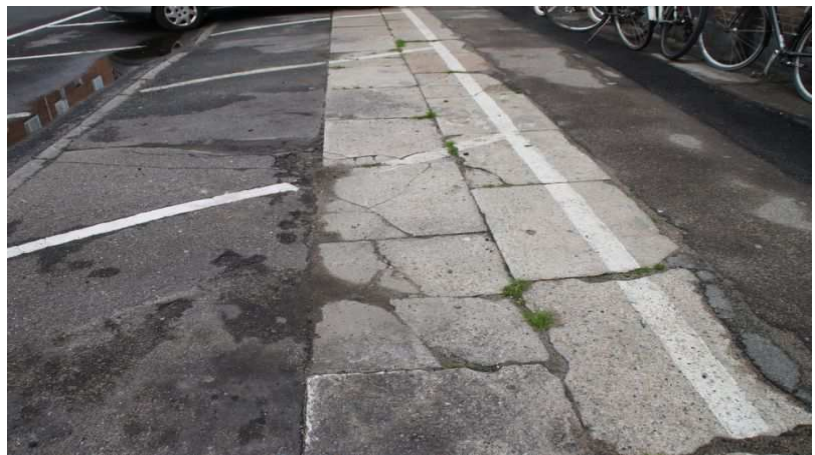
Defekte/knækkede fliser samt asfalterede områder
