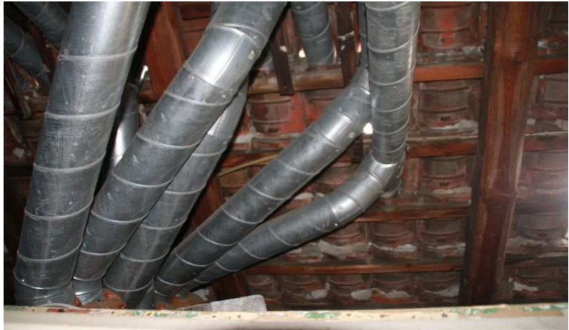
Område omkring ventilationsrør med flere huller i form af manglende understrygning
