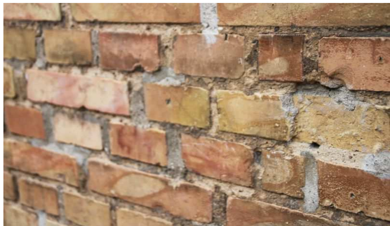
Facadesten på gårdfacade med manglende brandhud (overflade på facade sten mangler – samt generelt forvitrede fuger
