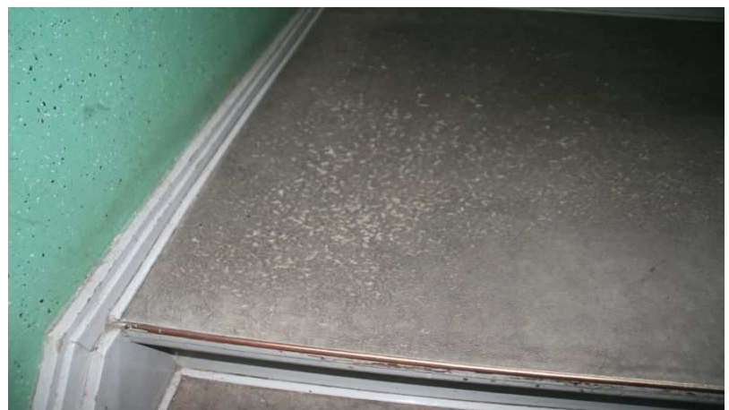
Forvitret/ødelagt linoleum på repose – hovedtrappe
