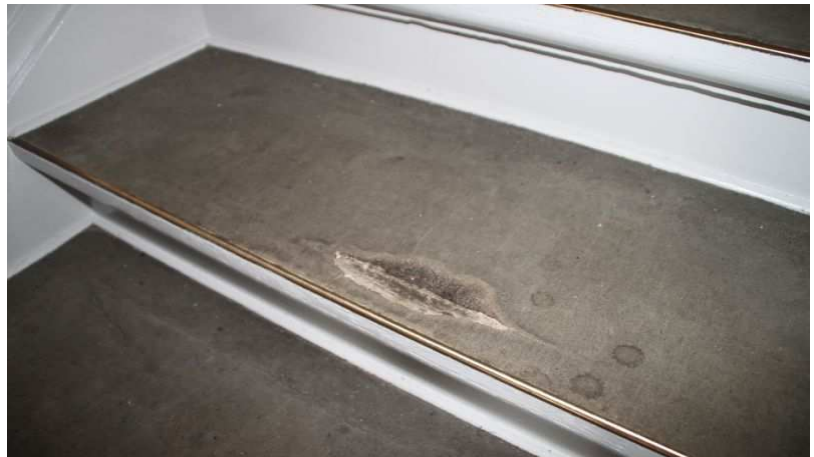
Hul i linoleumsbelægning på trappetrin – hovedtrappe
