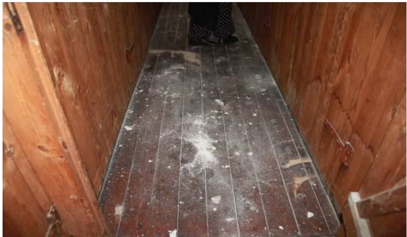
Mørtelrester/støv på gulv i tagetagen fra løs understrygning
