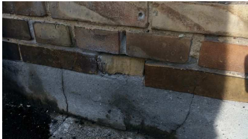
Revnet og opfugtet sokkel samt frostsprængt facadesten umiddelbart over sokkel
